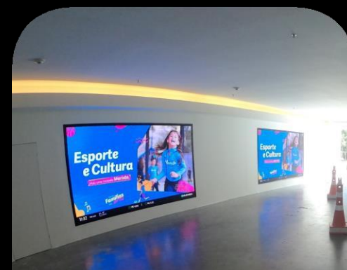
Painel led (estacionamento)
